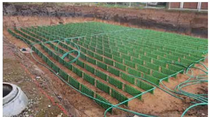
Mittlerweile sind die Kollektoren wieder von Erde bedeckt. Platzsparend in zwei Lagen übereinander versorgen sie die Wärmepumpe der Drei-Linden-Schule des Landkreises Würzburg zuverlässig und effizient mit Umweltwärme.
