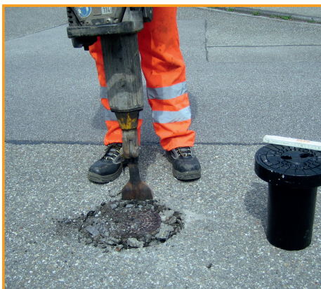
2. Nur geringer Aufbruch des Fahrbahnbelags
