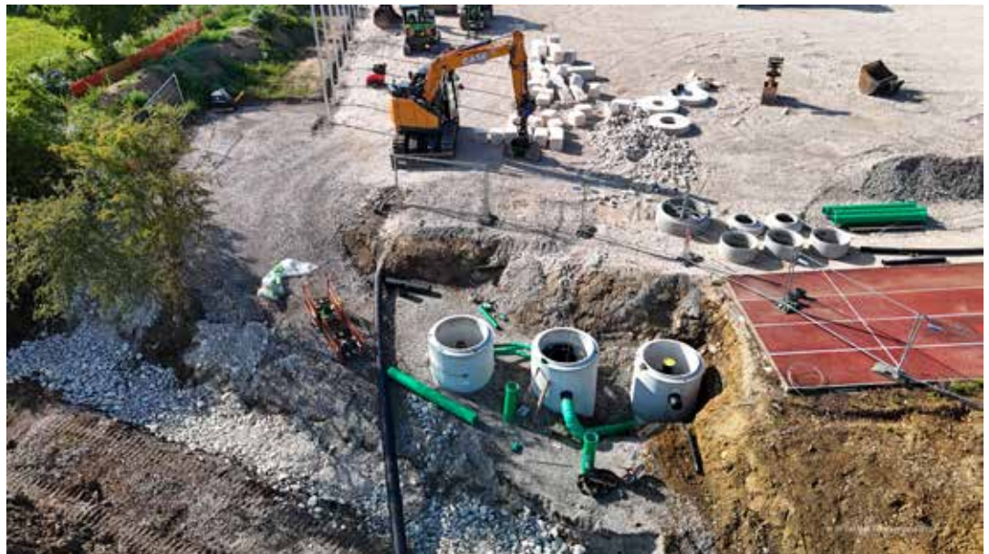
Bei der Modernisierung einer Sportanlage zum wettbewerbstauglichen Kunstrasenplatz setzte der Betreiber auf eine nachhaltige dreistufige Lösung zur Behandlung des abfließenden Regenwassers.
